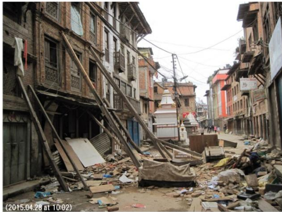
写真10 建物の倒壊を防ぐつかい棒
