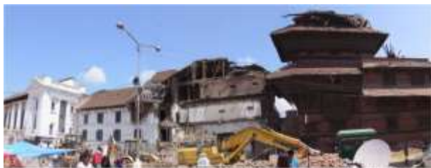
カトマンズのドゥルパール広場の旧王宮の建物：地震前(下)と地震後(上)
