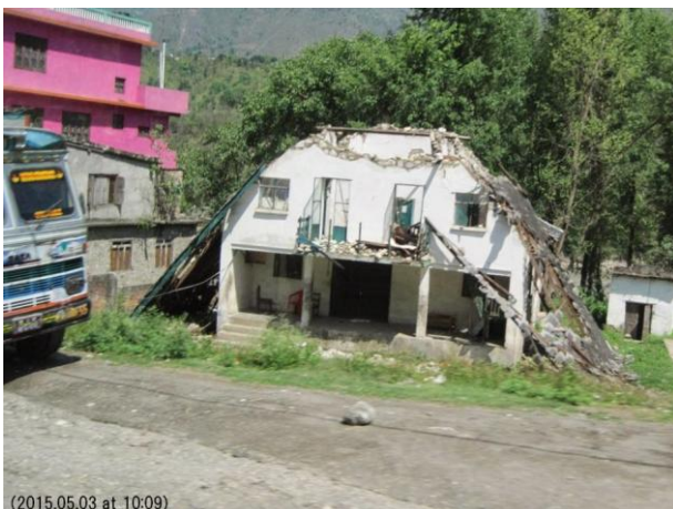
写真13 トリスリ川沿いの大きく破壊した民家
