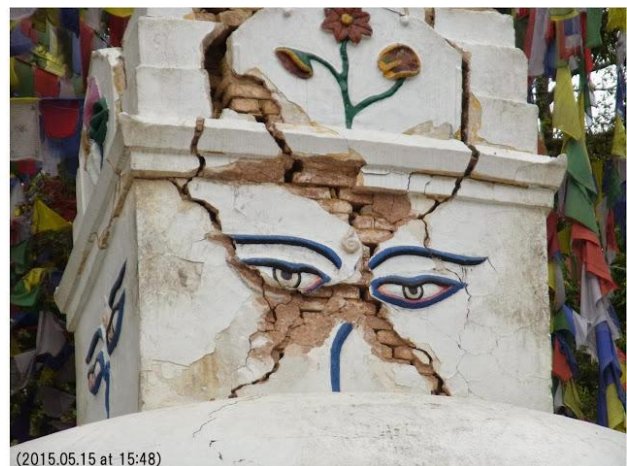
写真16 スワヤンブナート寺院の破壊した仏塔の亀裂
