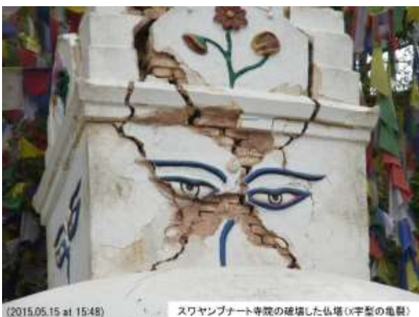
写真7 スワヤンブナート寺院の破壊した仏塔
