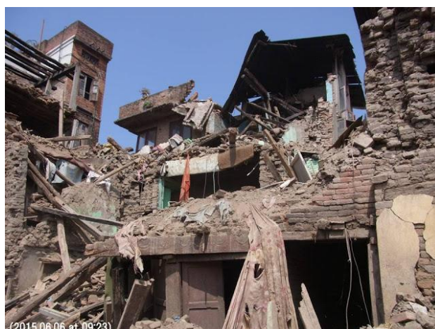
写真22 手をつけられないほどの著しい被災現場
