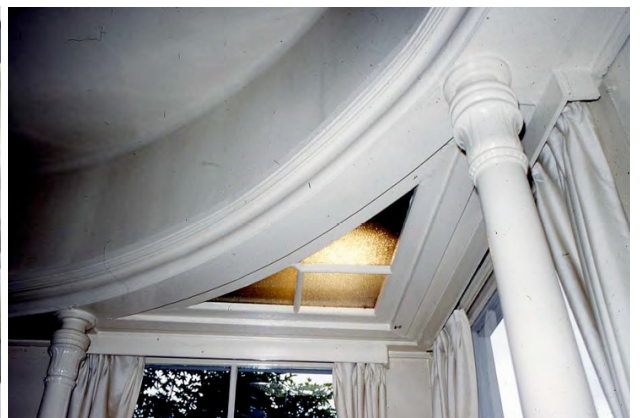
(f) 居間天井隅部
